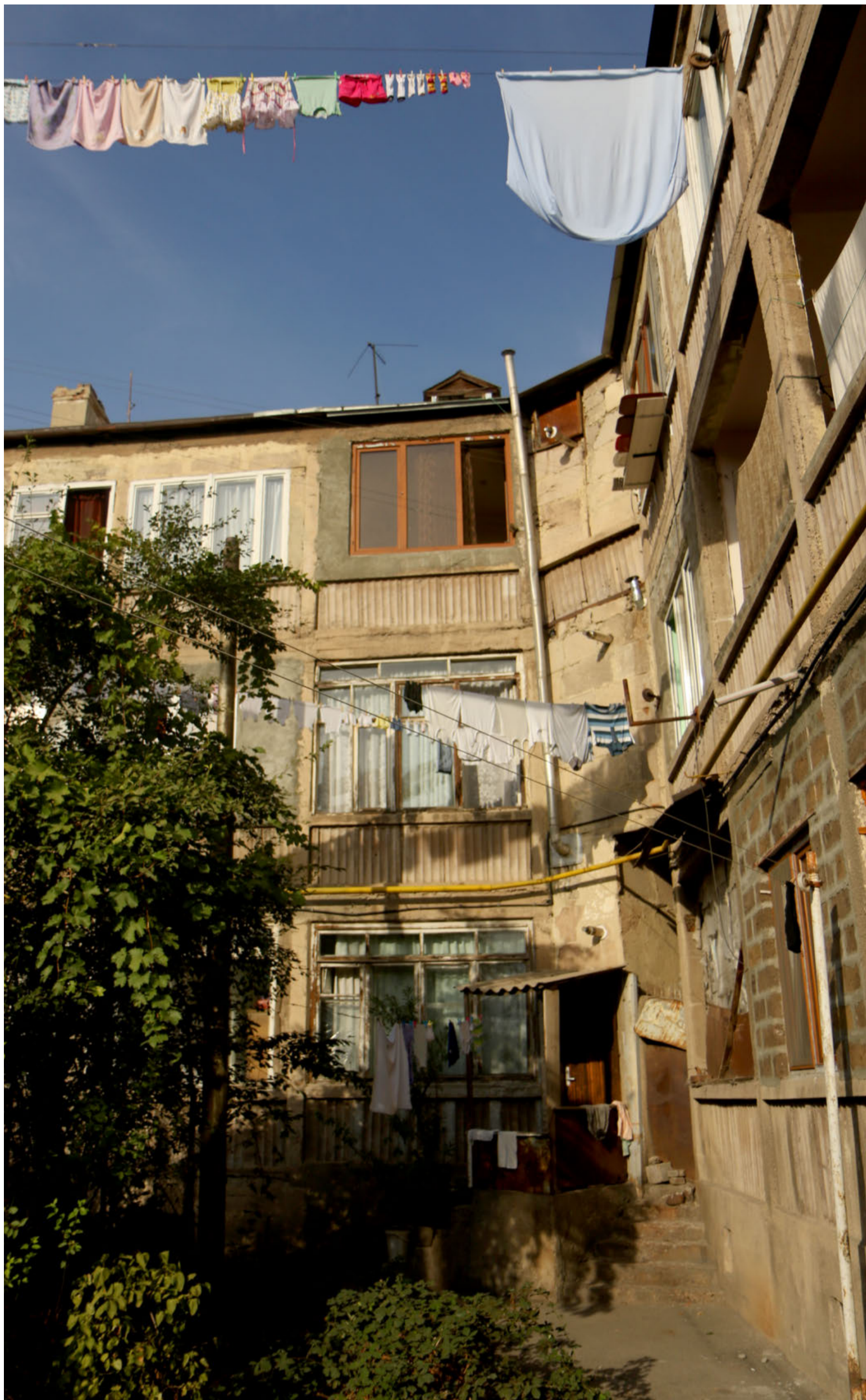
SPRAGLET. Det arkitektoniske ensemble synes at være et sammensurium af sporadiske reparationer med forhåndenværende materiale. Flere sjove udbygninger vidner om privat initiativ, men krænker samtidig husenens rene æstetik.
