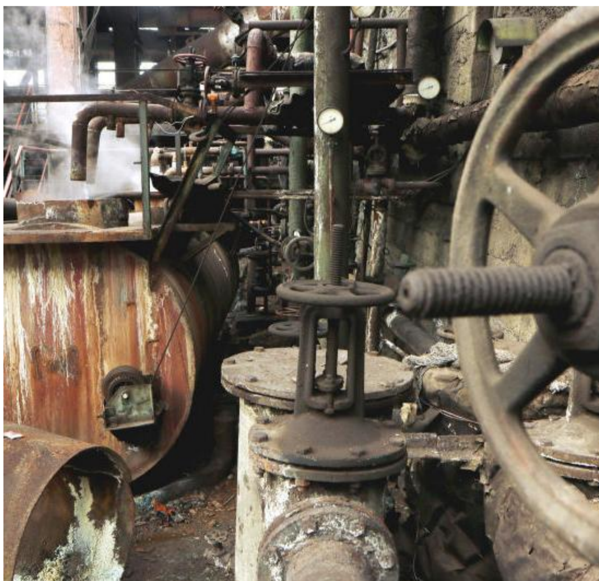
Anlagen und Arbeitsschutz wie von anno dunnemal: die Fabrik in Alawerdi
