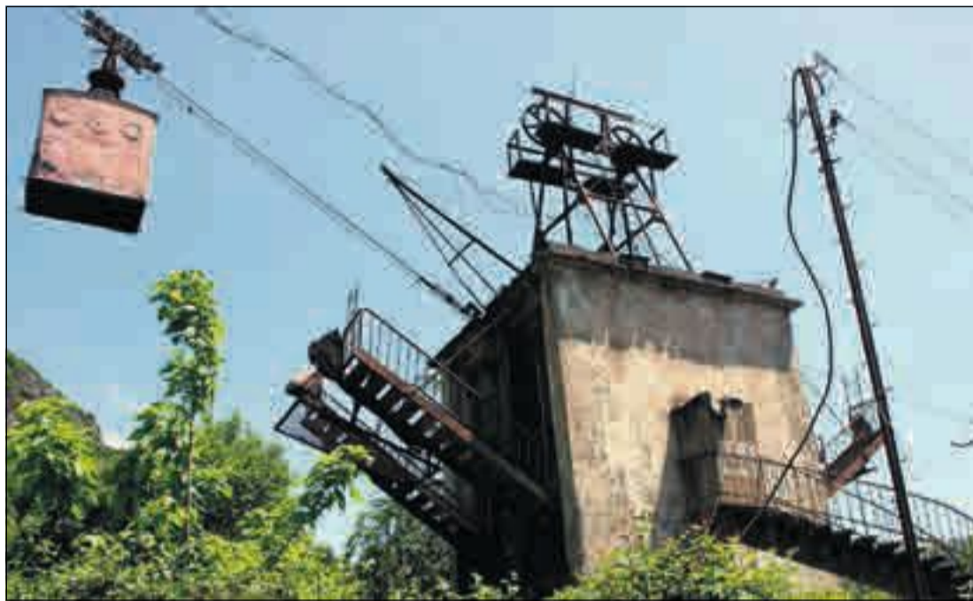
FORFALLER: Taubanenes skrøpelige tilstand vitner om at systemet ikke har vært renoveret i særlig grad siden 1970-tallet.
